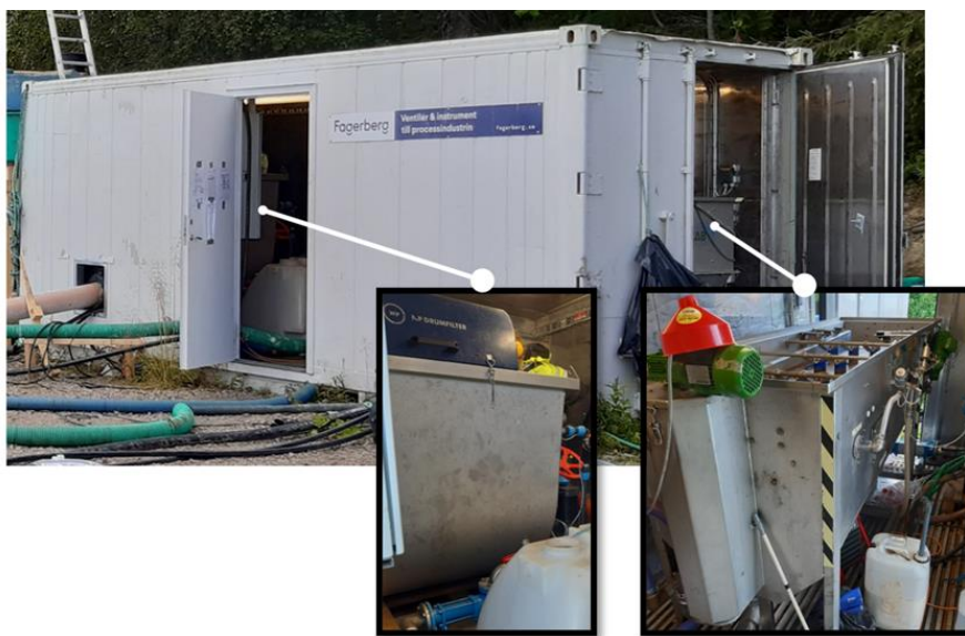
Figur 4. Avvattningsanläggningen på plats i Postviken.
