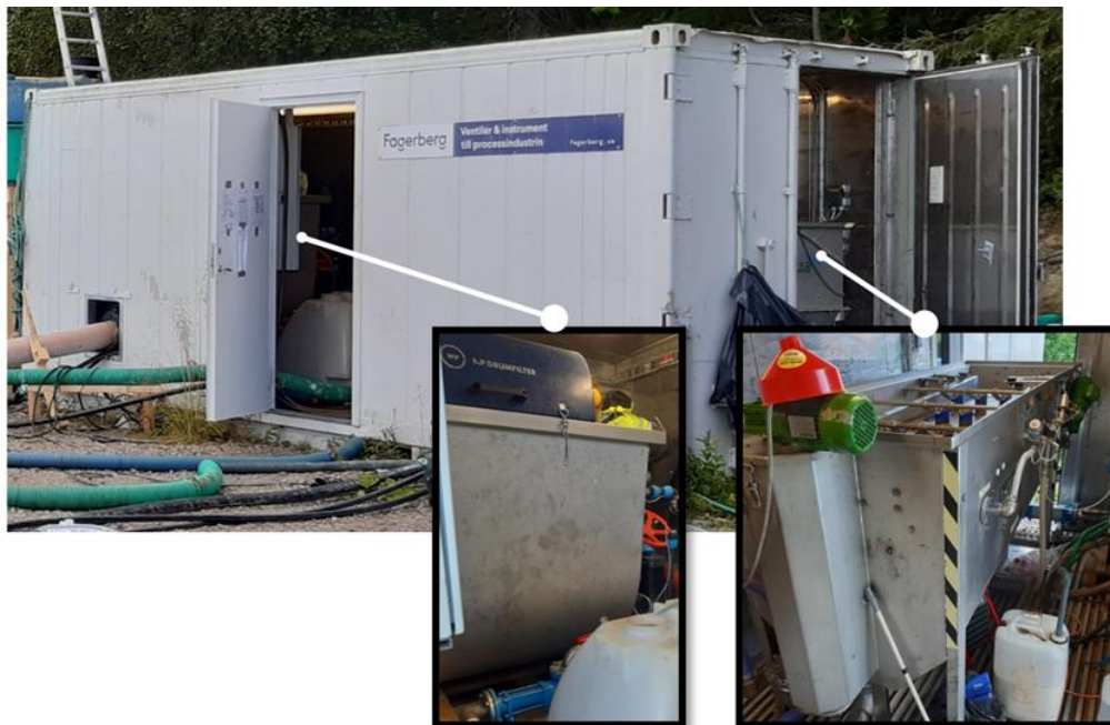
Figur 2. Avvattningsanläggningen på plats i Postviken, Strömsund. I den mindre bilden till vänster visas trumfiltret och till höger bandförtjockaren.
